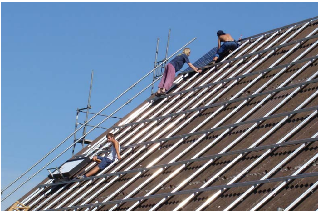
Anlage auf Scheunendach, Leistung 82.6 kWp
